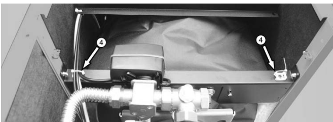
Abb. 25: Kabelführungen an der Querstrebe ④
