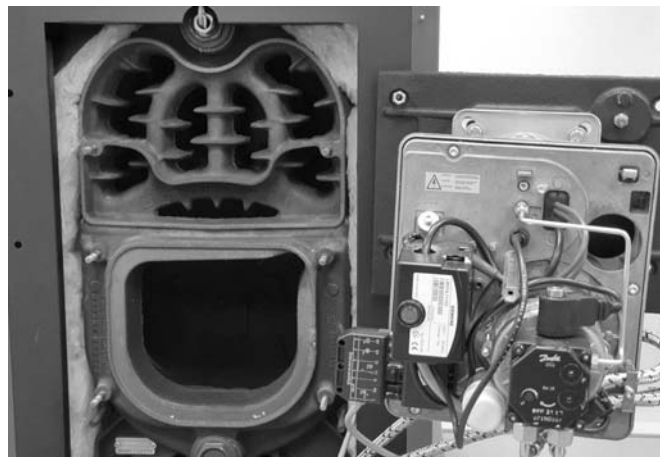
Abb. 85: Geöffneter Kessel mit Brenner in Serviceposition.
