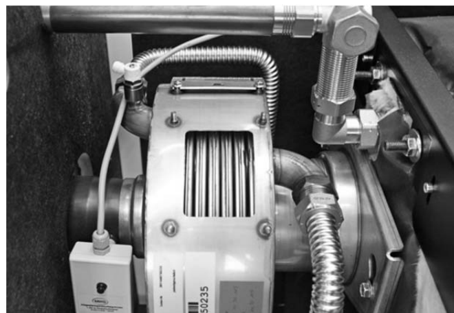
Abb. 88: Reinigungsöffnung des RWT
