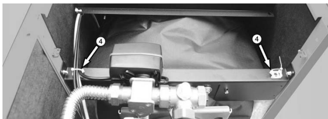
Abb. 25: Kabelführungen an der Querstrebe ④
