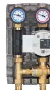
Abb. Ausführung mit Wilo Pumpe
